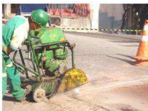
Figura 2: recorte da área danificada
