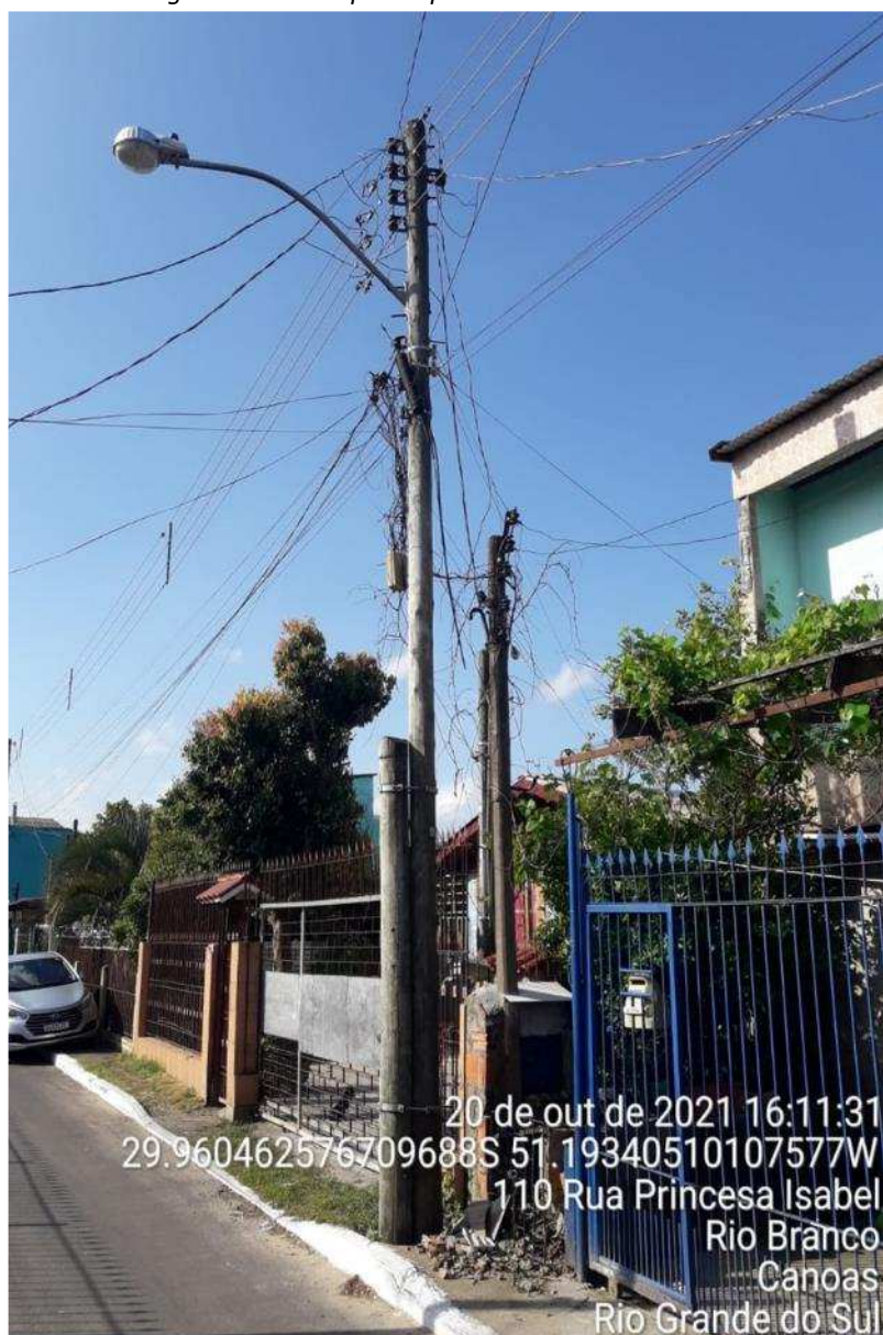
Figura 49 – Exemplo de ponto com Poste Avariado
