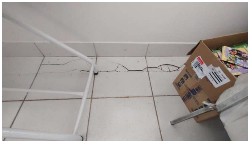
Figura 06: Piso interno com rachaduras (09.10.2025).
